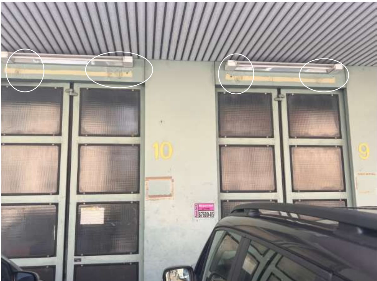
Abbildung 14: Vogelkotsuren unterhalb der Außenbeleuchtung an Tor 9 und 10.
