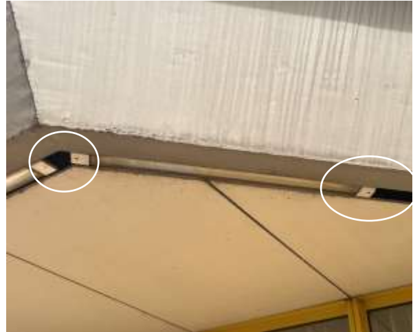
Abbildung 13: Hohlräume zwischen Beleuchtungselementen am Eingangsbereich der Postbank.
