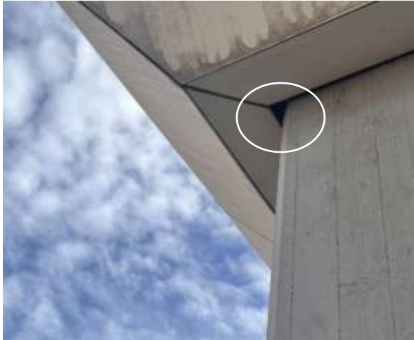
Abbildung 12: Hohlraum an Gebäudeecke.
