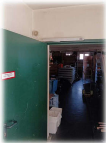
Brandschutztür mit Feststellanlage Richtung Bühne
