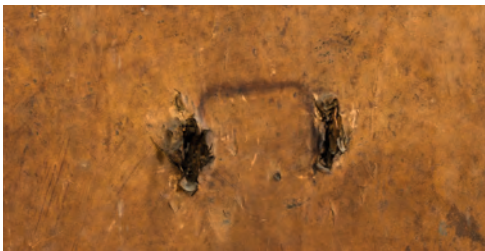
Montagelöcher der ausgerissenen Griffscharniere und Abklatsch des ursprünglichen Tragegriffes
