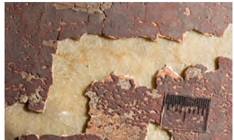
Der Ausbruchbrand der Malschicht offenbart bereits bei makroskopischer Betrachtung deren mehrschichtigen Aufbau.
